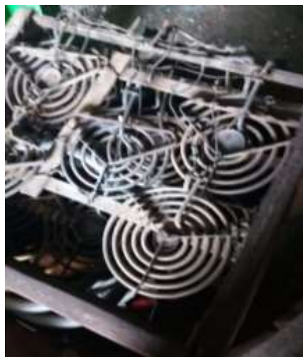
Ilustración 27. Resistencias eléctricas del termo 3 de la planta
