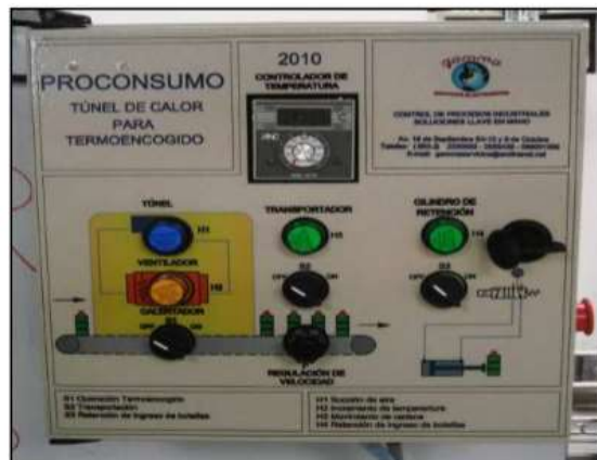
Ilustración 15. Tablero de control
