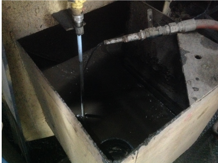
Figura No. 60: Rebosadero de filtro y electrodo de control automatizado de nivel de lodos.
