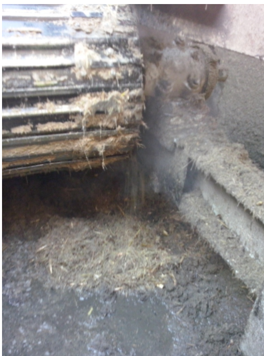
Figura No. 48: Bagacillo acumulado al costado de la banda transportadora y sobre las vigas que la sostienen.
