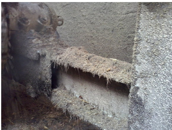
Figura No. 47: Acumulación de bagacillo en una viga.
