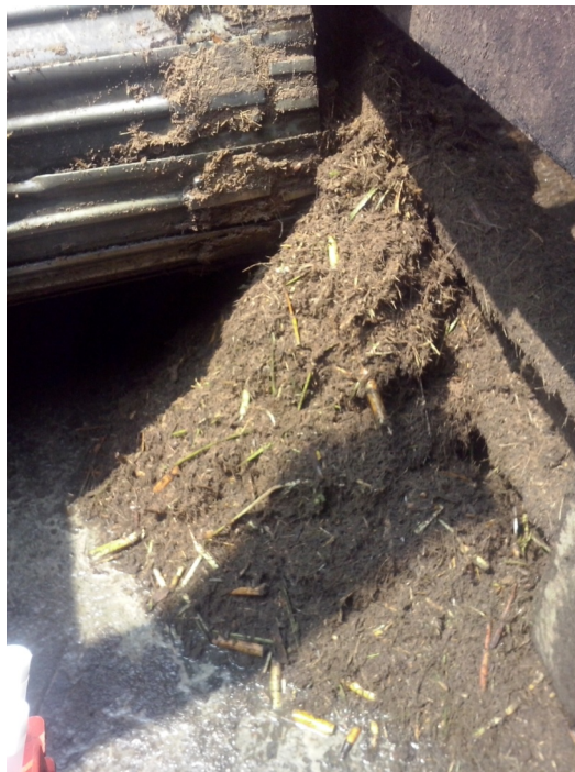
Figura No. 50: Acumulación No. 2 de debajo de conductor B. bagacillo en debajo de conductor B.
