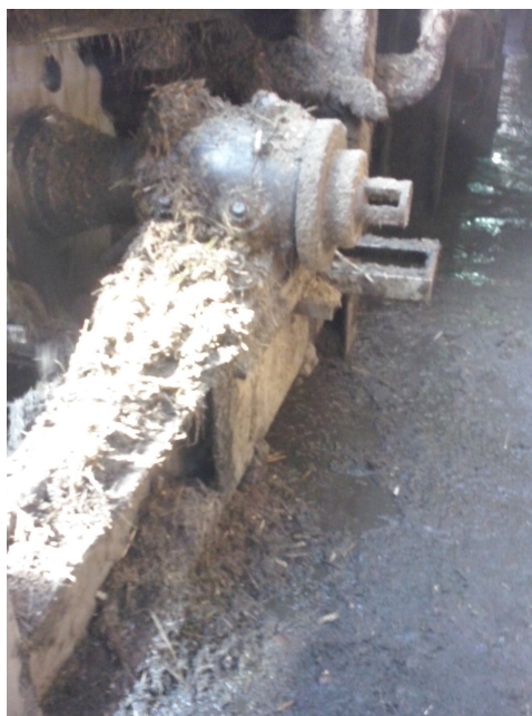
Figura No. 46: Acumulación de bagacillo en vigas de conductor.
