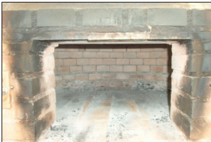
Figura No. 3 Fotos de caldera de biomasa y ladrillos refractarios
