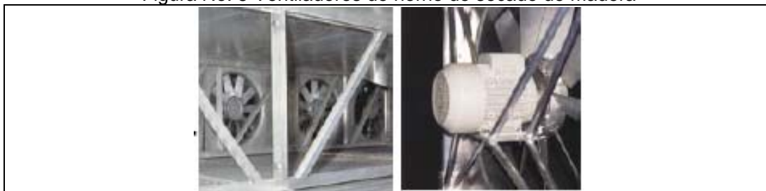
Figura No. 5 Ventiladores de horno de secado de madera
