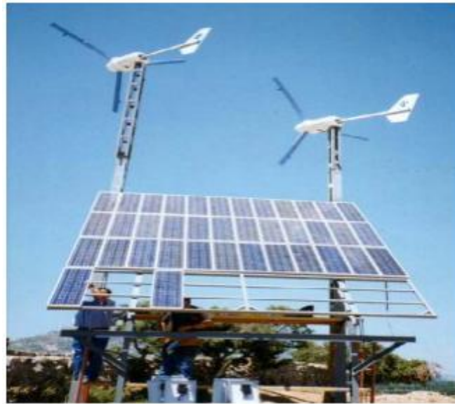
Ilustración 14. Instalación mixta eólica-fotovoltaica.
