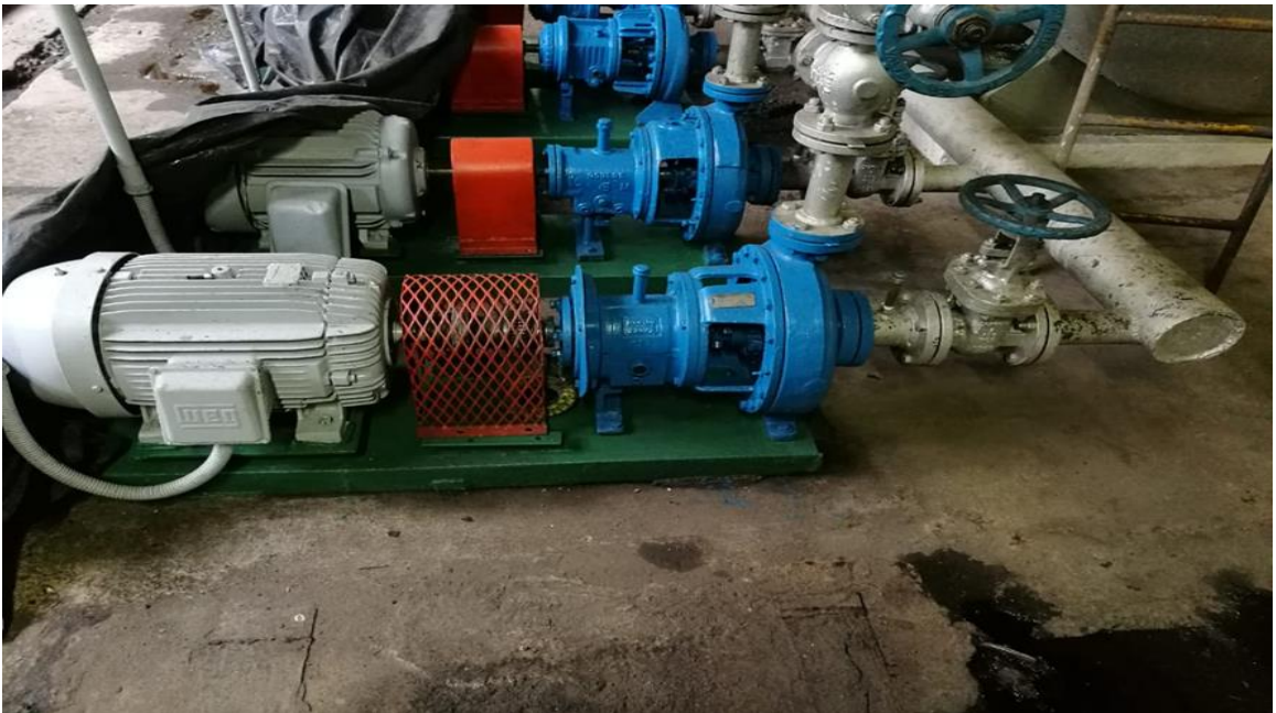
Figura No. 19. Motor y bombas sistema
