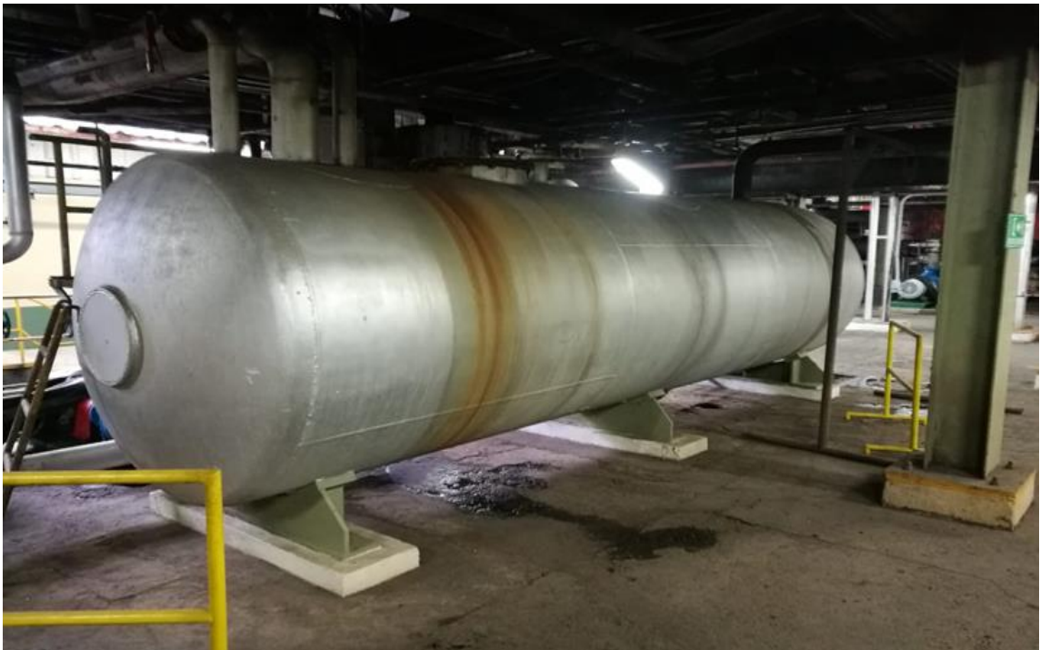
Figura No 17. Tanque de condensado
