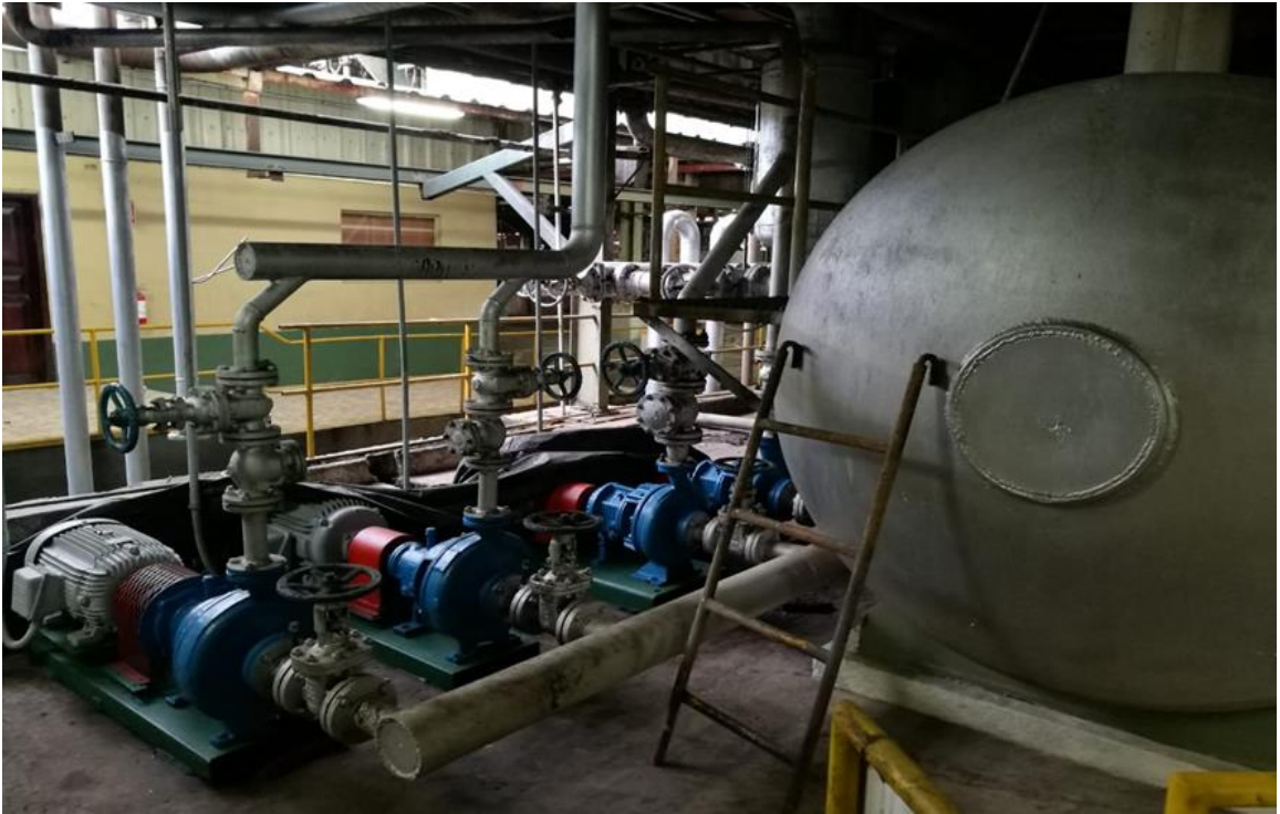
Figura No. 18. Sistema de válvulas
