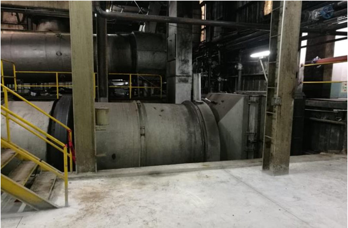
Figura No 16 Vista lateral de secadora de azúcar, entrada de aire
