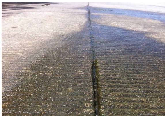
Ilustración No. 30. Drenaje ineficiente en pavimento de losas cortas.
