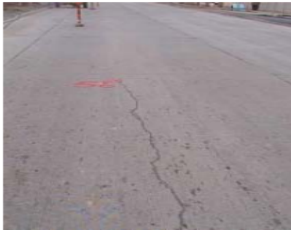
Ilustración No. 6. Grieta longitudinal en un pavimento rígido.
