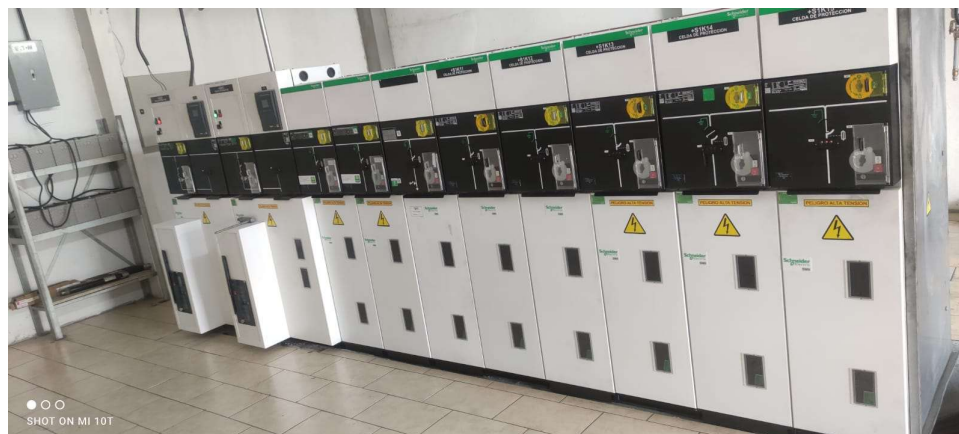
Figura 38. Tren de celdas instalado en cuarto eléctrico de centro comercial
