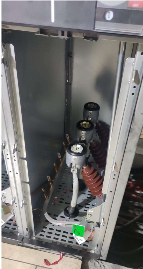
Figura 36. interior de celda de salida tipo desconector con fusible
