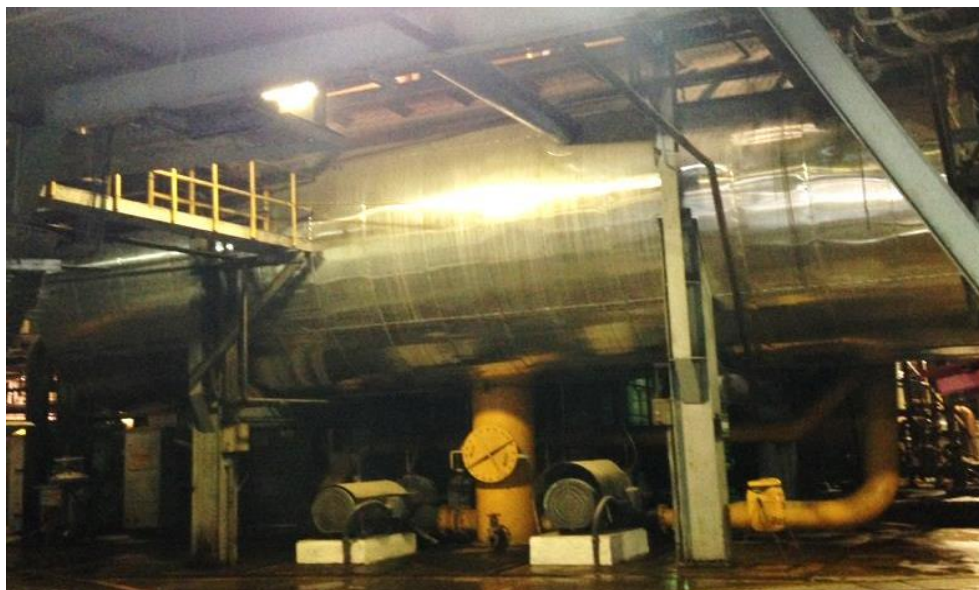
Figura 28: Vista frontal tanque de jugo claro con aislamiento térmico.
