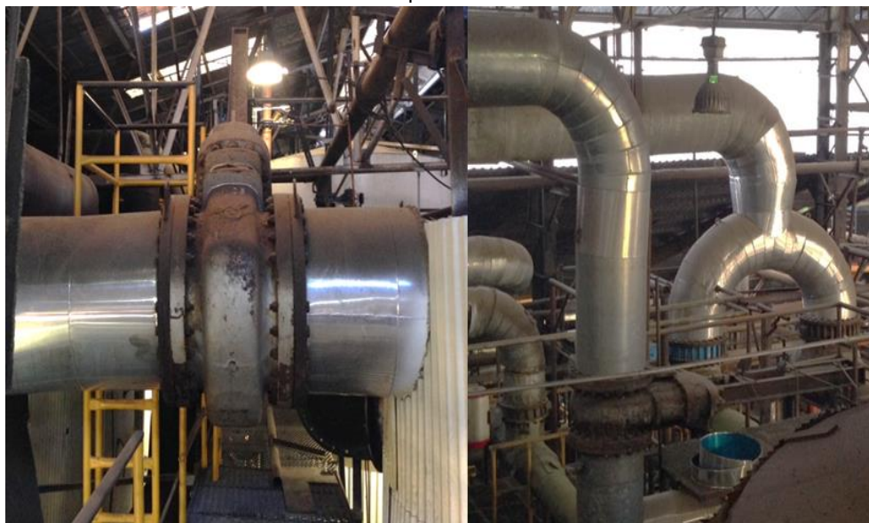
Figura 26: Aislamiento térmico en tuberías de vapor entre vasos evaporadores y hacia calentadores de placas.
