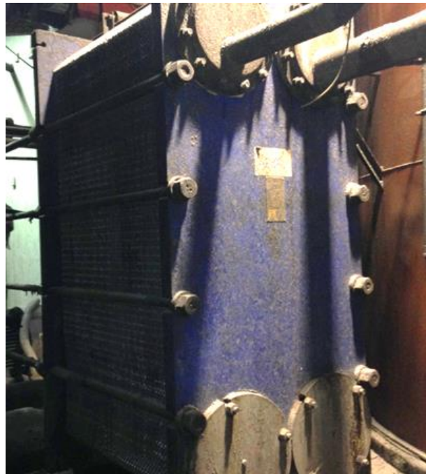
Figura 33: Calentador de placas parte del sistema del nuevo tanque para agua de condensados.
