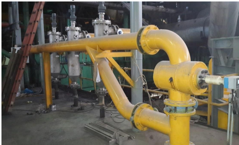
Figura 31: Vista lateral filtros de meladura.
