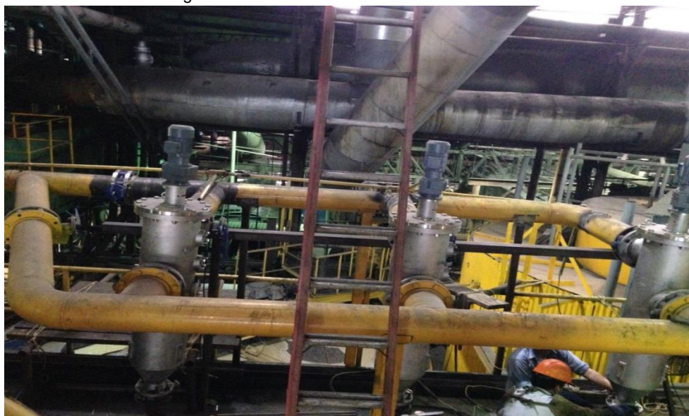
Figura 30: Instalación final de filtros de meladura
