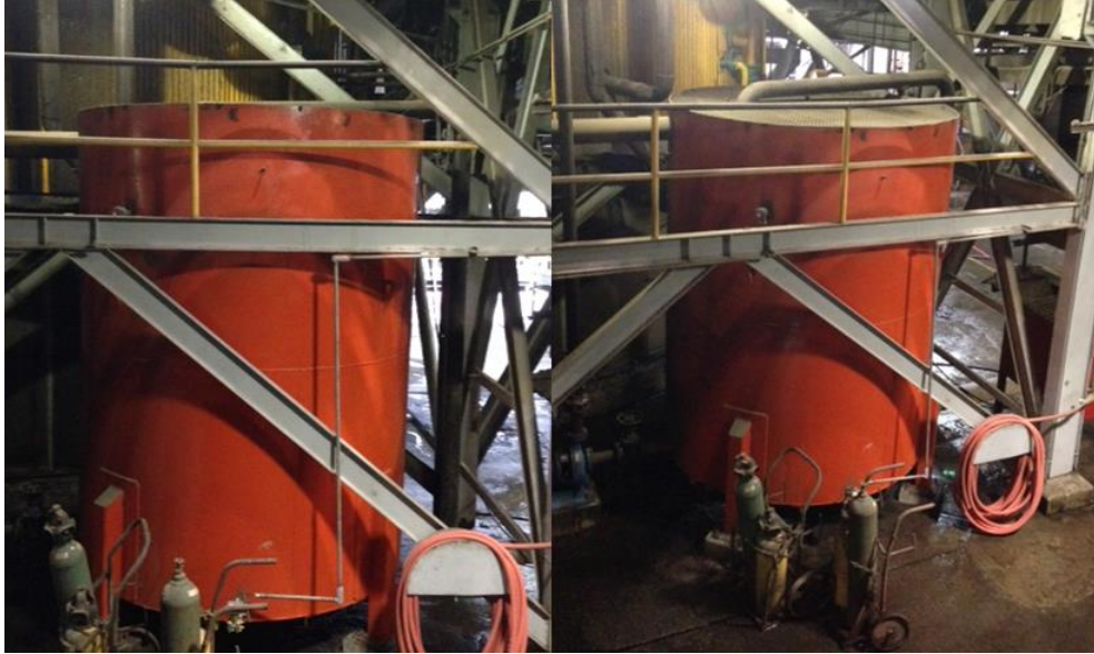
Figura 32: Vista frontal y lateral del tanque para agua de condensados.
