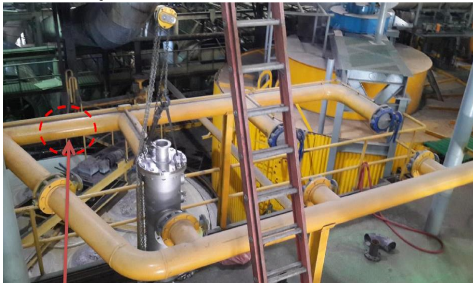
Figura 29: Proceso de instalación de los filtros de meladura
