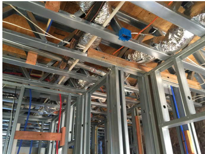
Figura 79: Instalación de conductos y tuberías hidráulicas y eléctricas en la losa de entrepiso
