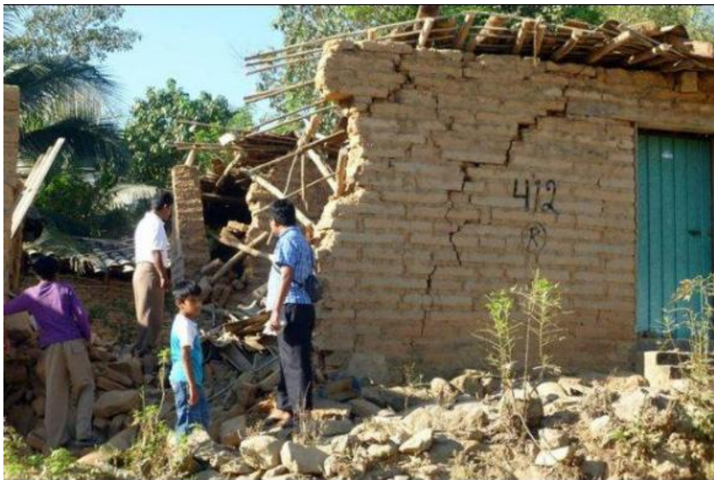
Figura 81: Resultado de una vivienda de adobe luego de un evento sísmico
