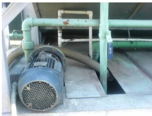
Ilustración No. 9. Motor de la bomba
