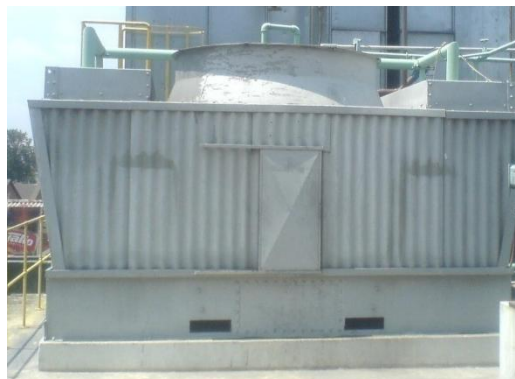
Ilustración No. 59. Torre de enfriamiento Marley
