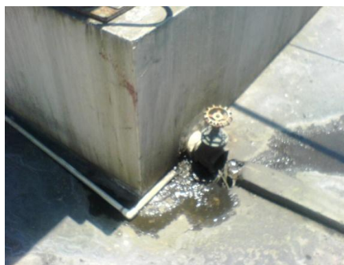
Ilustración No. 25. Fugas en las tuberías y válvulas
