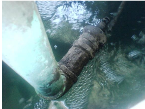
Ilustración No. 26. Sedimentaciones en las tuberías
