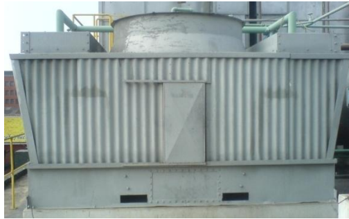
Ilustración No. 1. Torre de enfriamiento Marley
