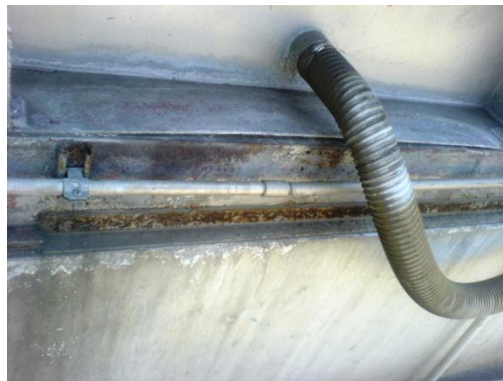
Ilustración No. 27. Corrosión en la estructura y fuga en la tubería
