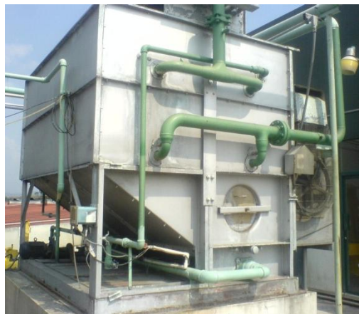
Ilustración No. 7. Condensador evaporador Mjönnier
