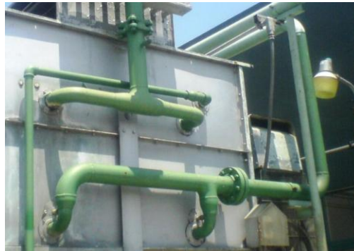
Ilustración No. 14. Tubería del sistema
