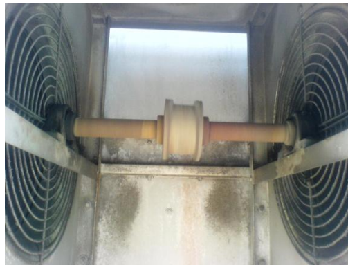
Ilustración No. 28. Eje y acople (desalineado y oxidado)
