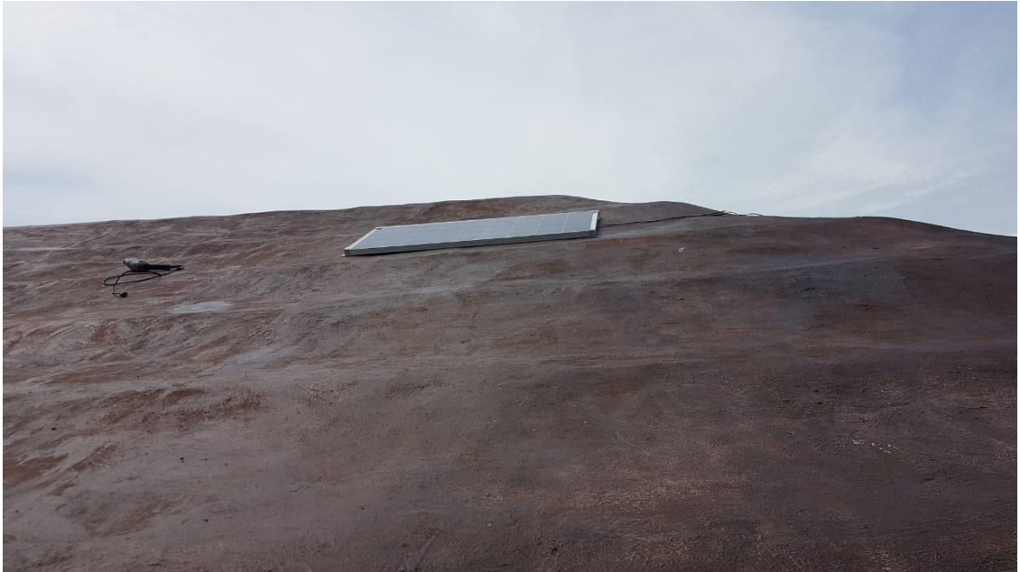
Figura 25. Foto real del panel solar ya instalado en el techo
