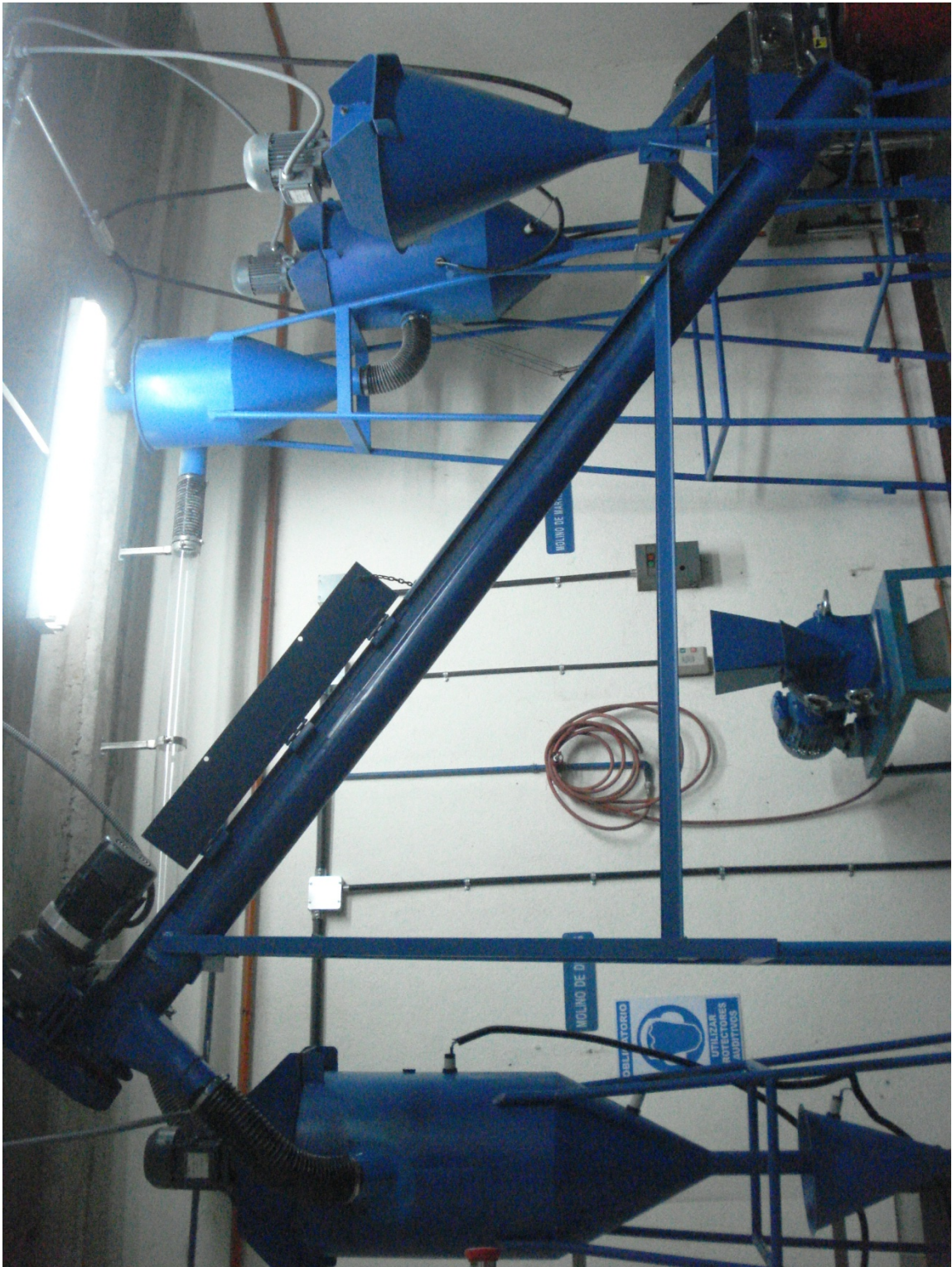
Figura 35. Imagen del área de sólidos automatizada.
