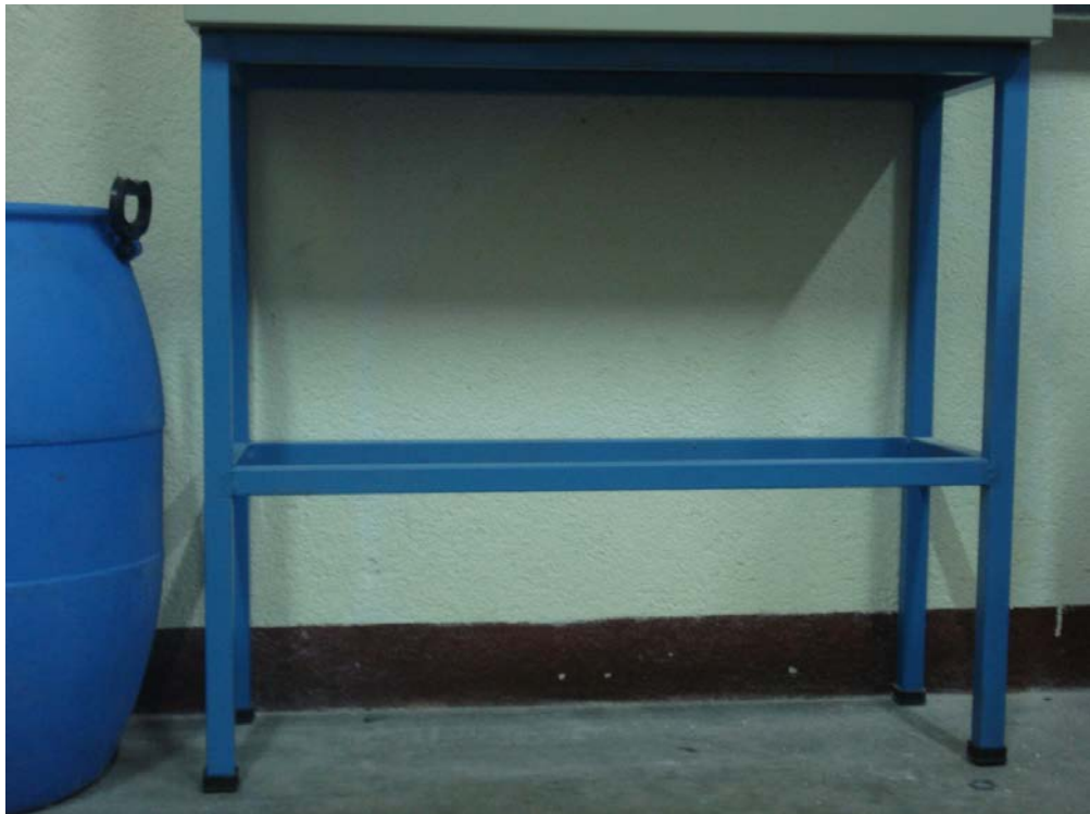
Figura 26. Imagen de la estructura de soporte del panel de control.
