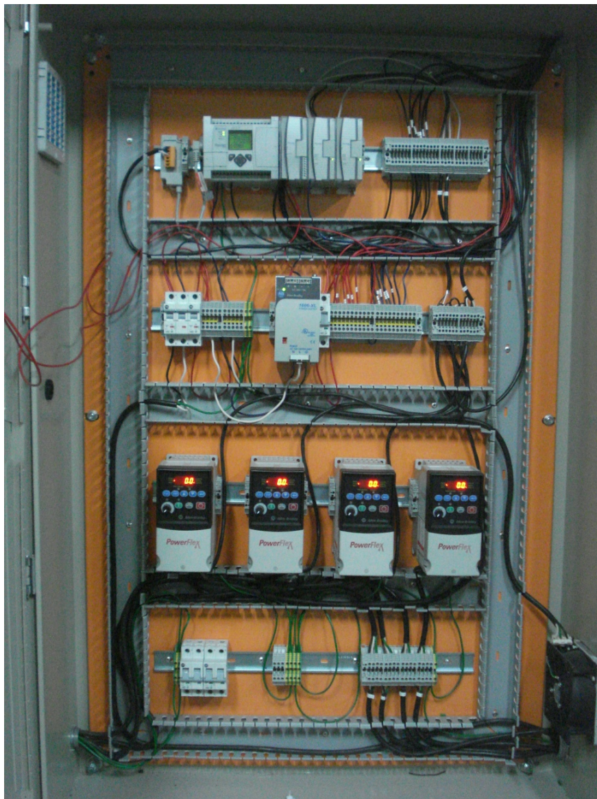
Figura 30. Imagen del equipo montado en panel de control.
