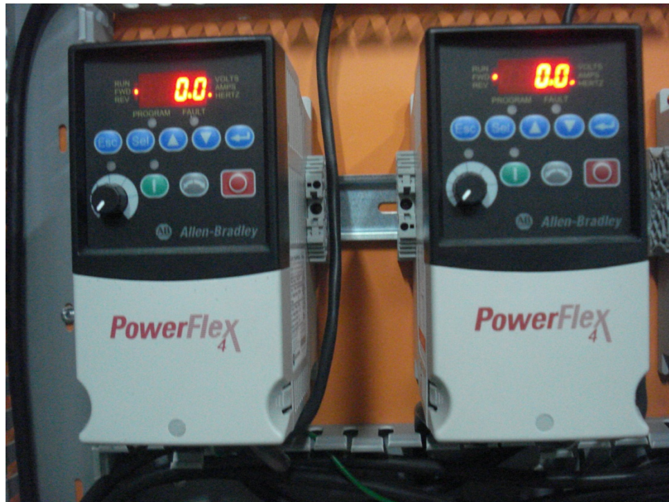
Figura 32. Imagen de variadores de frecuencia instalados en el panel de control.
