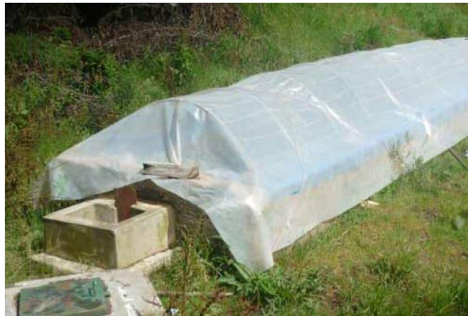
Figura 28. Biodigestor instalado, con invernadero
