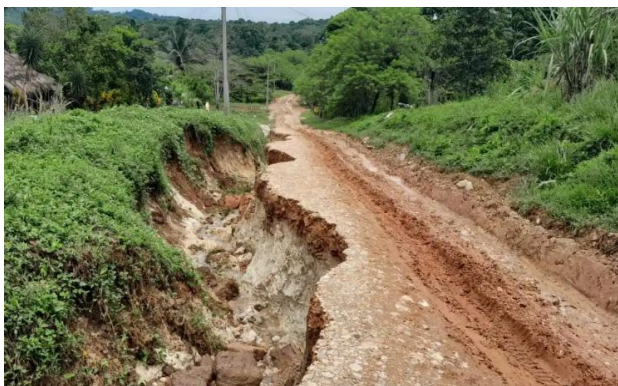
Figura 22. Colapso de tramo carretero por fallas en drenaje en Ixcán, Quiché Fuente: (Barreno, 2022)
