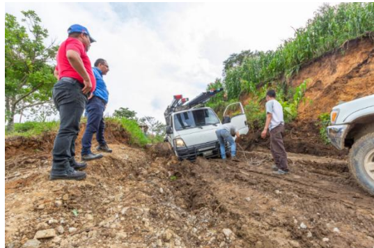
Figura 21. Construcción de tramo carretero con sección transversal incorrecta Fuente: (Herrera, 2021)
