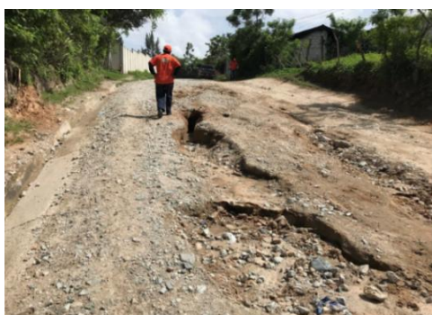
Figura 26. Agregado suelto y erosión de suelo en camino de terracería Fuente: (Siliezar, 2021)
