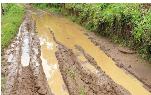
Figura 25. Ahuellamientos en camino de terracería Fuente: (Álvarez, 2023)
