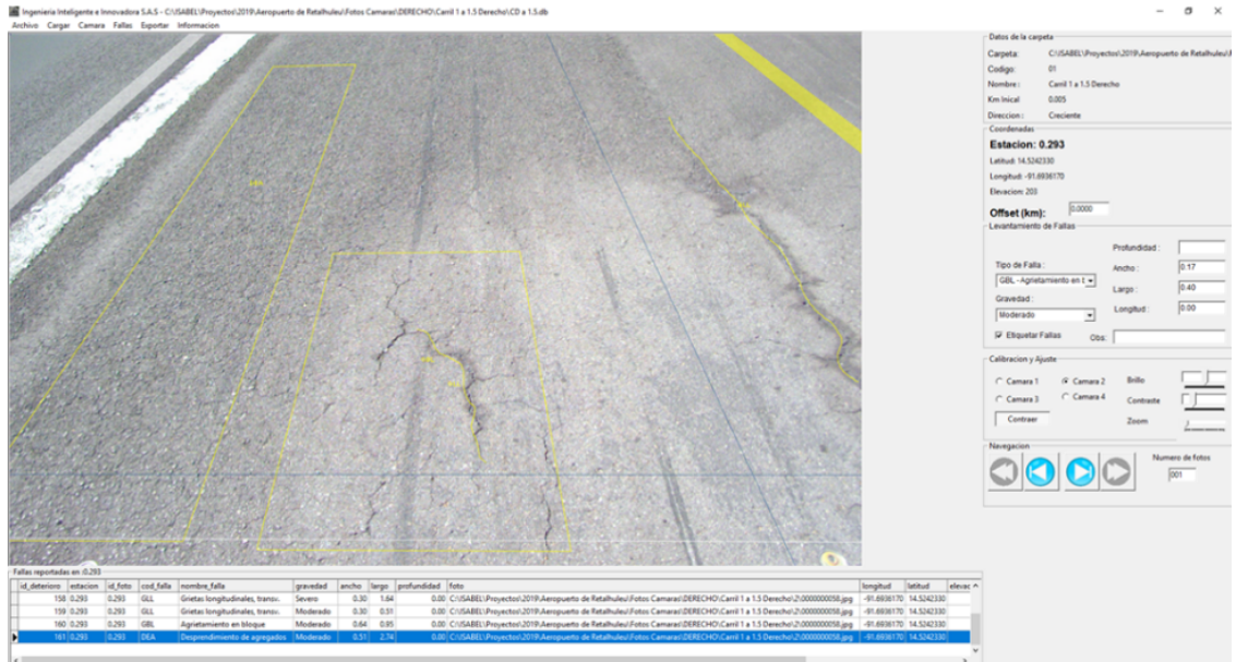
Figura 44: Selección de fallas tipo bloque y linear para un pavimento utilizando LDis
