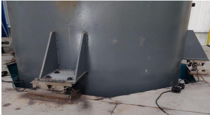
Ilustración 10 - Tanque con celdas de carga
