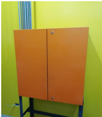
Ilustración 11 - Tablero de mando montaje
