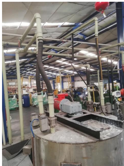
Ilustración 7 - Tubería bombas a tanques
