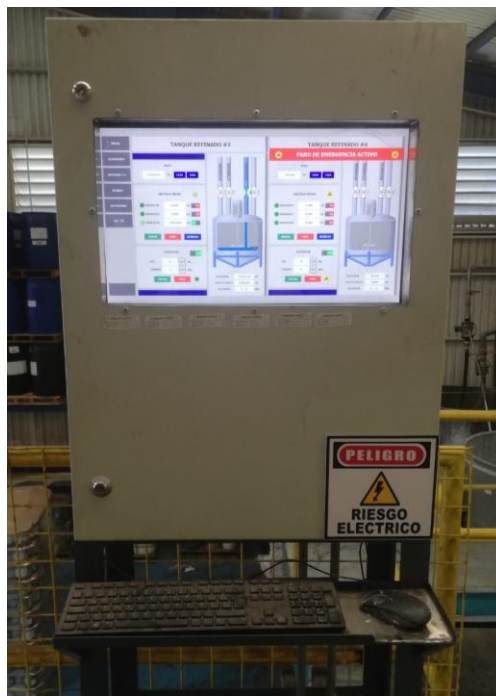
Ilustración 17 - Tablero con pantalla HMI
