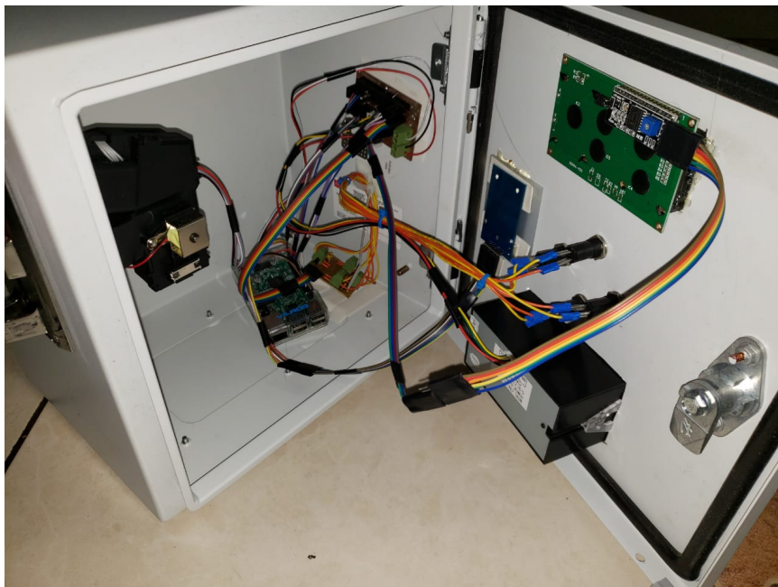
Figura 34: Vista interna de la segunda versión de la plataforma en el gabinete metálico
