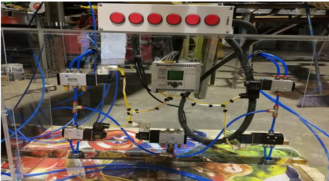
Figura 51. Distribución de sistemas de mando y potencia dentro del gabinete
