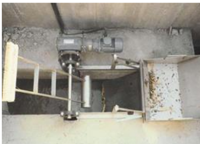
Ilustración 11: Vista superior rejilla de limpieza automática
