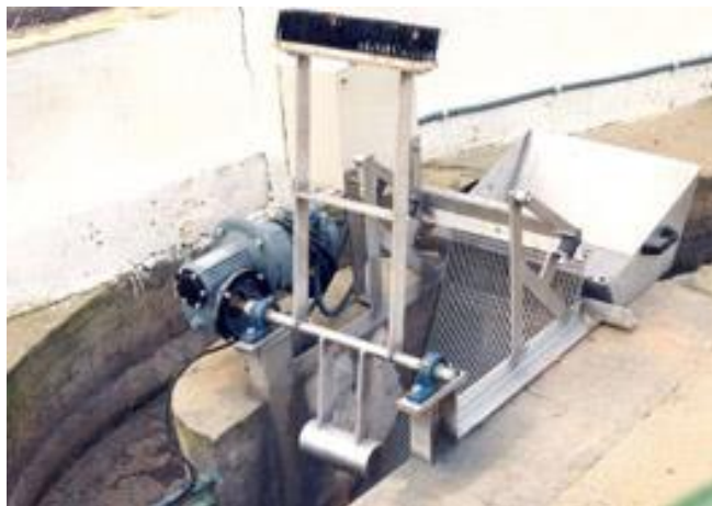
Ilustración 10: Rejilla de limpieza automática 10
