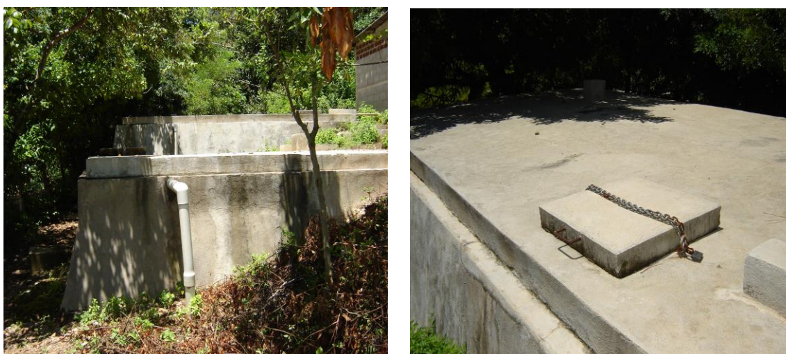
ILUSTRACIÓN 7-Tanques actuales de distribución
