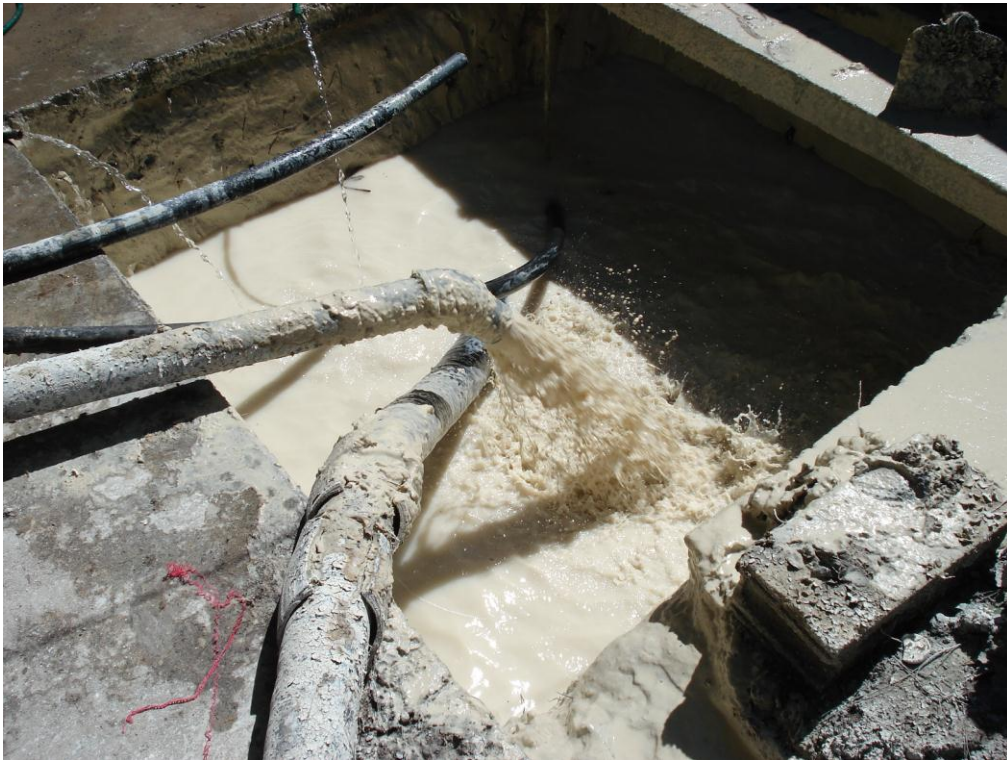
Imagen 30. Pila de preparación de lodos.
