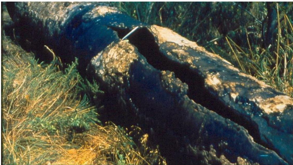
Imagen 16. Corrosión de tubería metálica.
