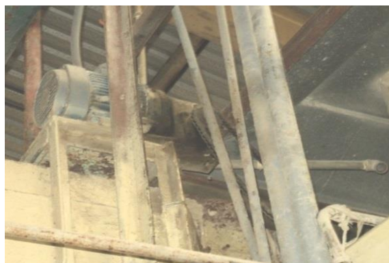
Figura 4. Ejecución programa 5's. Muestra de problemas con la maquinaria, falta de guarda en cadena con un motor de la compresora de jabón en la línea 6 de producción.
