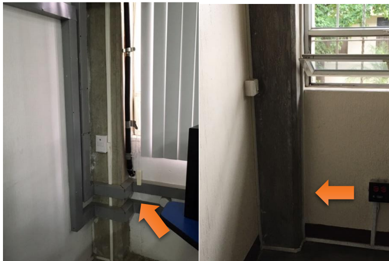
Ilustración 17 – Presencia de columna corta
