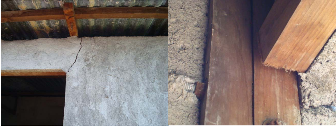
Figura 6: Grieta causada por el desprendimiento de un perno.
