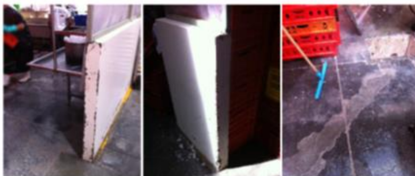
Despostillamientos en aristas
