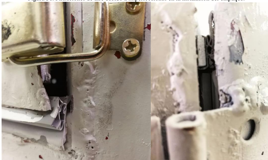
Figura 36. Filtraciones de aire debido a imperfecciones en la instalación del empaque.
