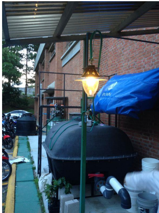
Lustración 29: Fotografía de sistema completo con lámpara de biogás instalada en Universidad del Valle de Guatemala y producido a partir de desechos orgánicos de Zoológico “La Aurora”
