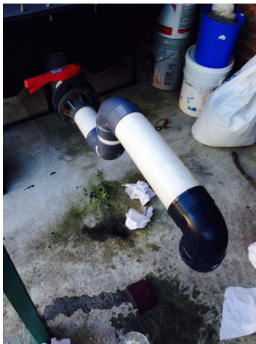
Ilustración 30: Sistema de purga para salida de residuos de biodigestión anaerobica
