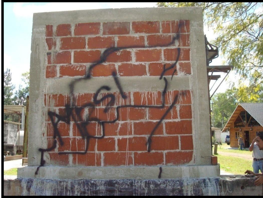
Ilustración 90. Falla a corte de muro 1 con solera intermedia.
