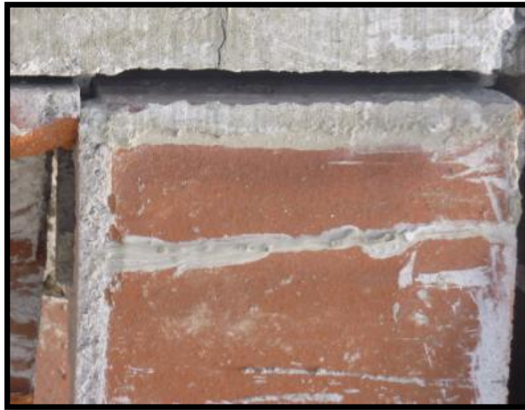
Ilustración 97. Falla de adherencia entre mortero y ladrillo.
