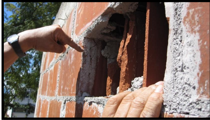
Ilustración 100. Grietas en la parte central de la mampostería.
