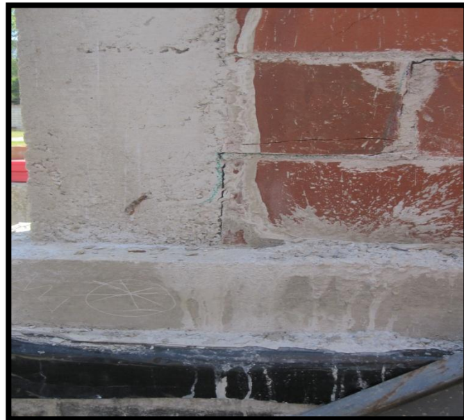
Ilustración 99. Grietas en el extremo inferior opuesto del lado de aplicación de carga.
