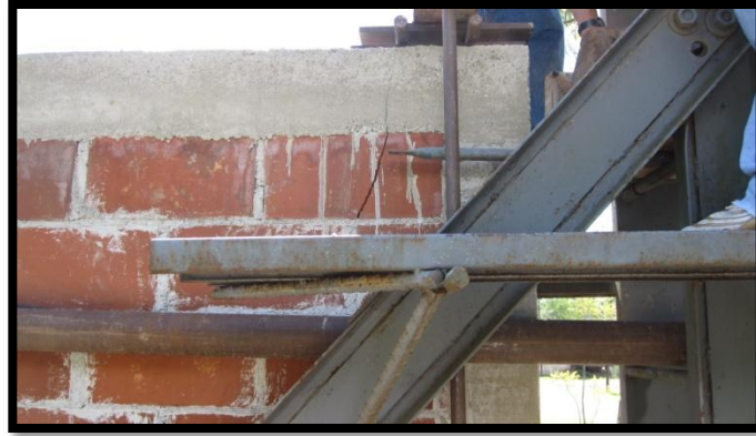
Ilustración 98. Grietas en el extremo de aplicación de carga.
