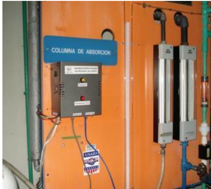
Figura 19. Botonera y medidores de flujo de la segunda fase de automatización
