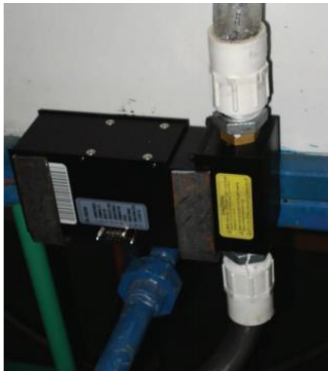
Figura 20. Válvulas proporcionales segunda fase de automatización.
