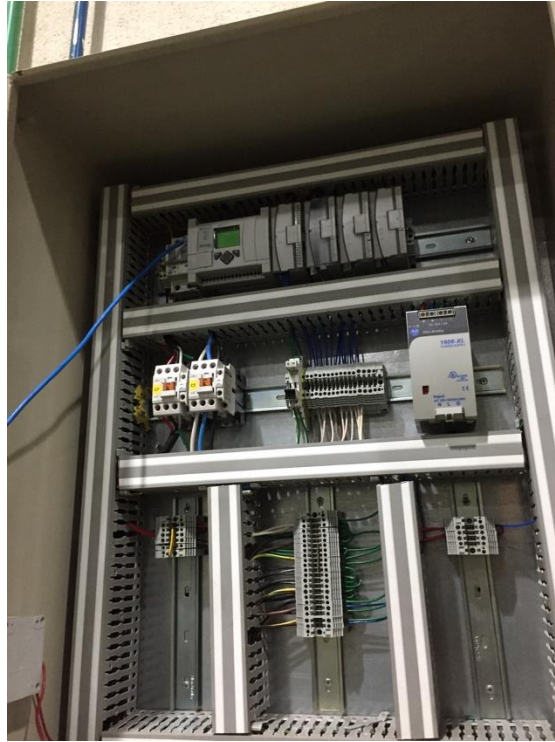
Figura 29. Tablero de torre de absorción
