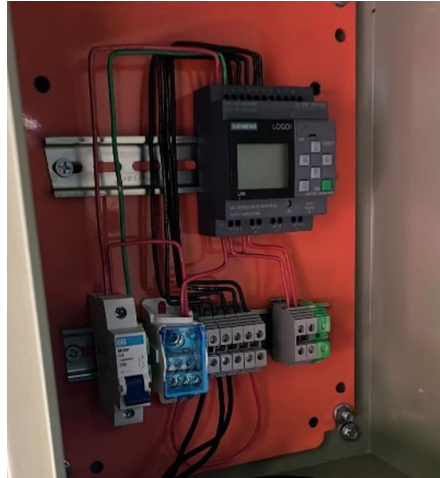
Figura 71: Instalación del LOGO! y circuito eléctrico.
