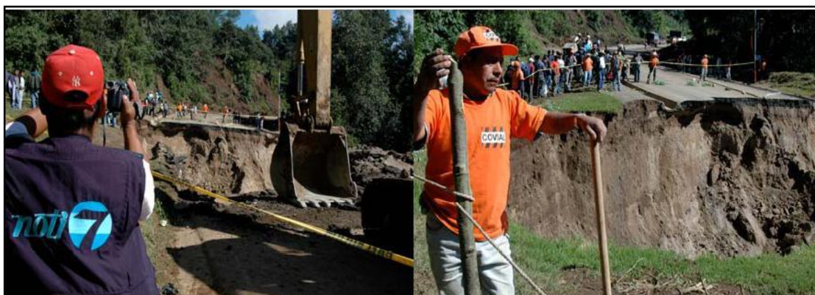
FOTO 2-1. VISTA DEL PUNTO EN DONDE COLAPSO LA CARRETERA Y EN DONDE SE PUEDE APRECIAR LA PENDIENTE Y CURVA DE LA MISMA.
