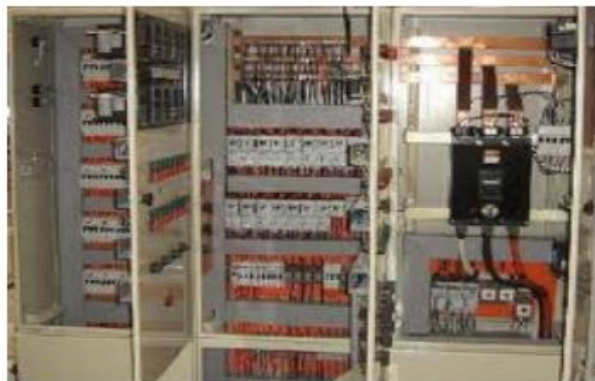
Figura 4.21: Tablero de fuerza[20]
