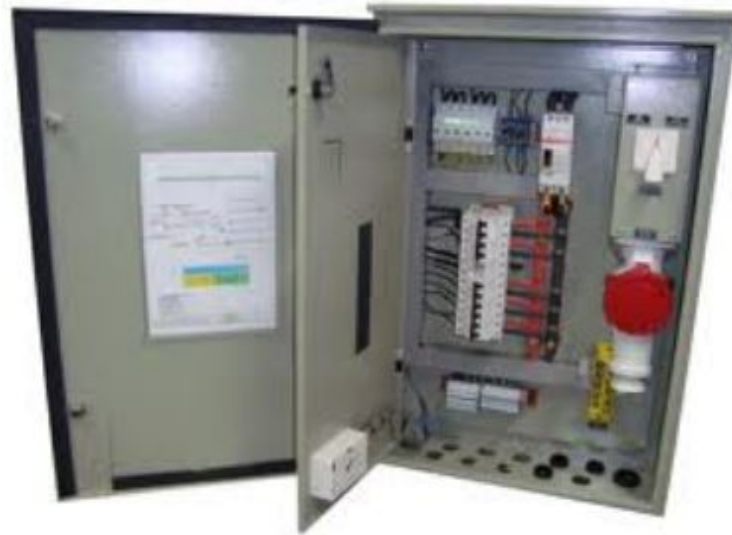
Figura 4.20: Tablero de distribución[20]
