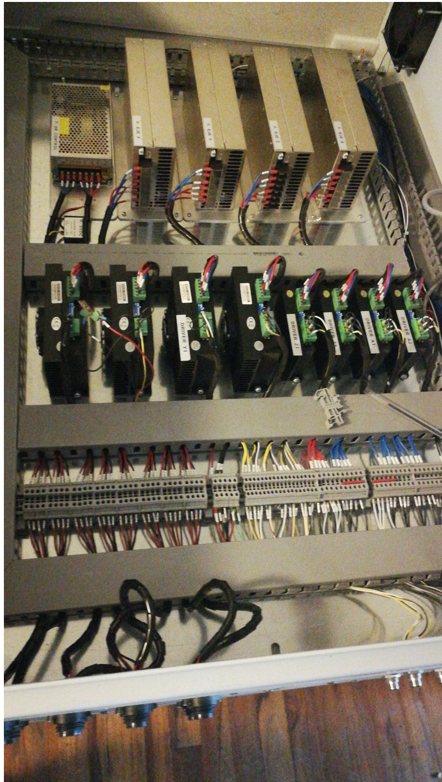
Figura 6.16: Cableado de conexiones del gabinete de potencia.
