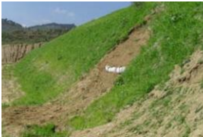
Imagen 121: Hidrosiembra en taludes afectada por el exceso de agua de los taludes
