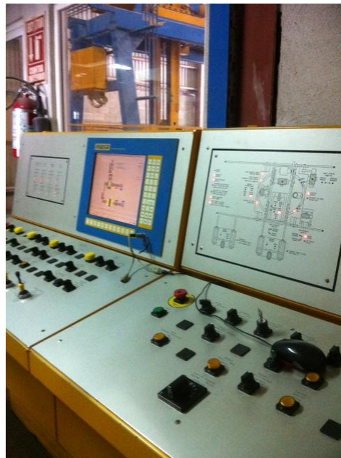
Imagen 36: Cuarto de máquinas para el control de humedad
