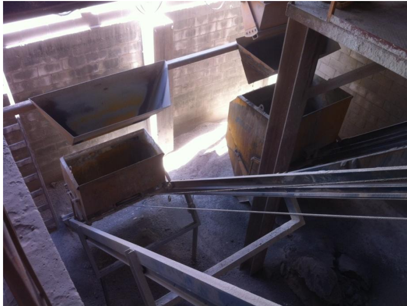
Imagen 35: Tolva que suben el material a la máquina mezcladora
