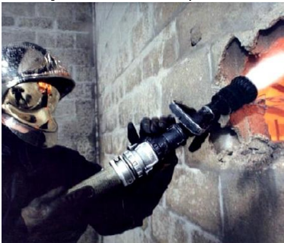
Imagen 195: Edificación de block bajo un incendio.
