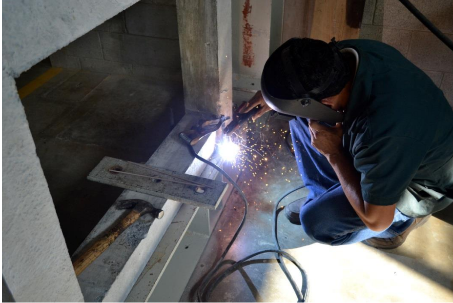
Imagen 17. Proceso de soldado en el apoyo rediseñado durante el ensayo del modelo físico.
