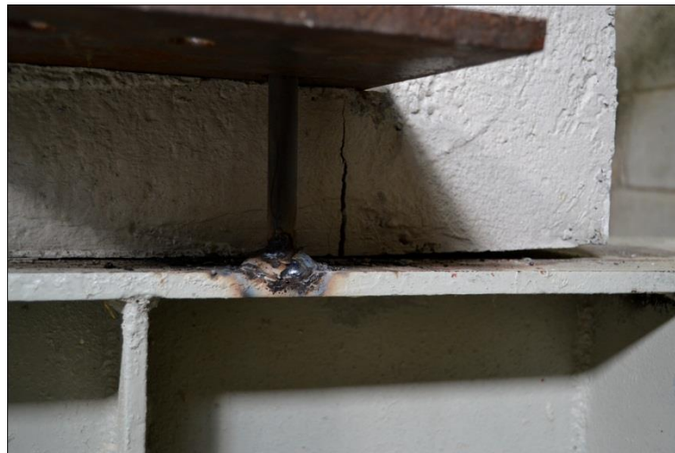
Imagen 15. Apoyo con excentricidad en el modelo físico.
