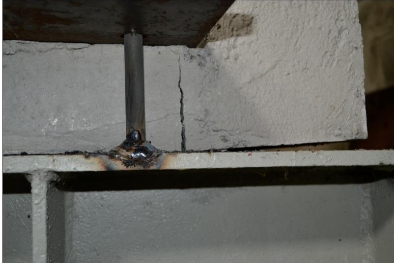
Imagen 16. Efecto de volteo en la columna derecha del marco de microconcreto.
