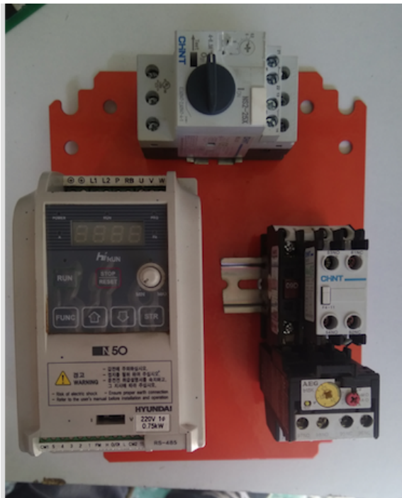
Figura 45: Elementos del panel eléctrico
