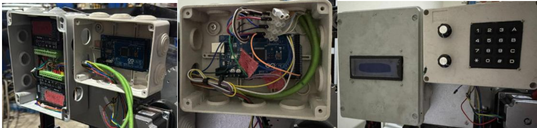
Figura 32. Conexiones eléctricas dentro de cajas plexo
