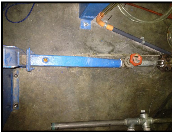
Figura No. 26 Válvula para ventilador y placa de orificio
