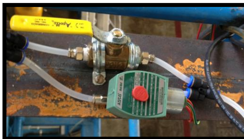
Figura No. 62 Válvulas
