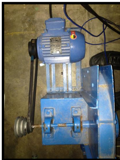
Figura No. 25 Sistema de motor y ventilador
