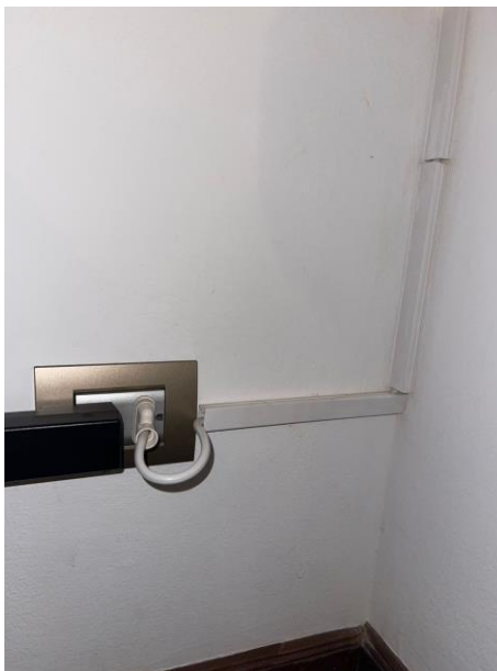
Figura 36. Imagen capturada dentro de la vivienda mostrando como se conectan las persianas motorizadas a los tomacorrientes existentes.
