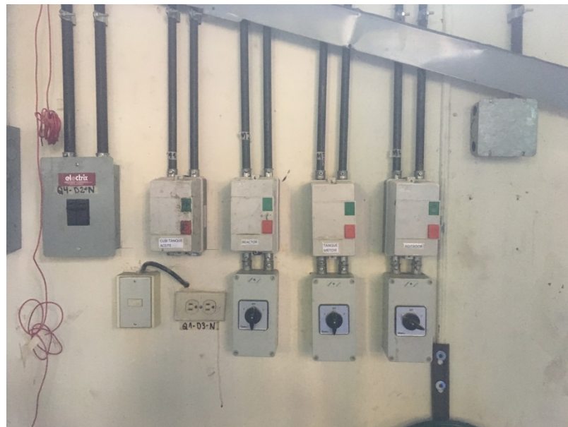
Figura 8: Botones para el funcionamiento de motores en forma manual
