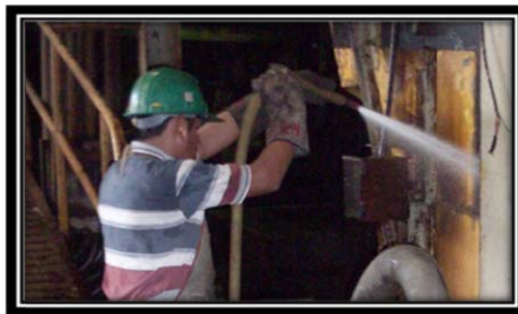
Ilustración 53 Estado del EPP utilizado y la falta de EPP.
