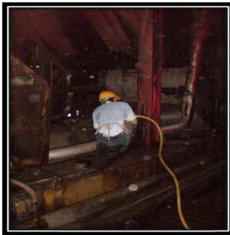
Ilustración 54 Imagen del operador a un costado del molino.
