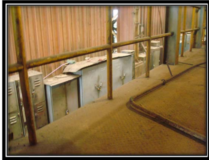
Ilustración 55 Diseño incorrecto de barandas del segundo piso y escaleras, falta de rodapié.
