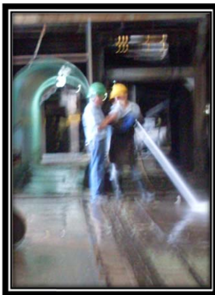
Ilustración 58 Desperdicio de agua y peligro latente de quemaduras.
