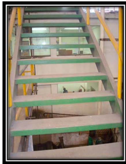
Ilustración 56 Rodapié muy bajo en las escaleras que conducen al segundo nivel.
