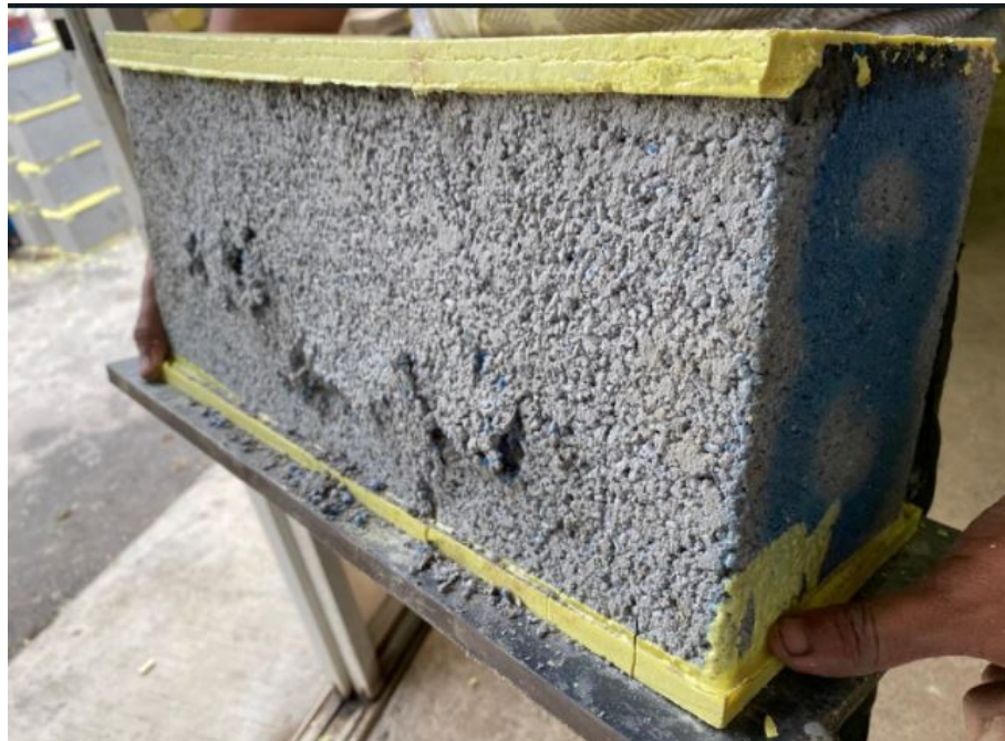
Figura 37. Falla por separación de pared externa de unidad según NTG 41051 h2
