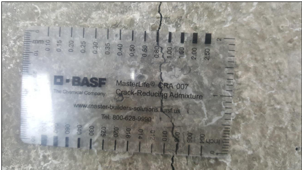
Gráfico 34: Medición del ancho de la fisura
