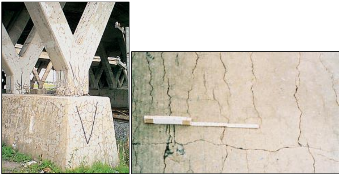
Gráfico 8: Fisuras causadas por las RAS
