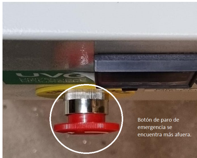
Figura 10. Paro de emergencia desactivado
