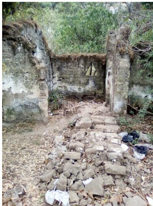
Figura II-4: entrada principal de la residencia y muro derrumbado (Foto por D. Morales).
