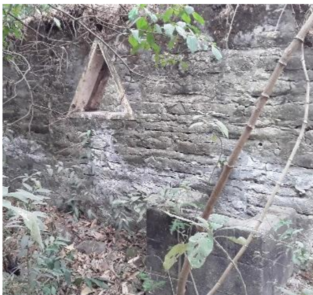
Figura II-7: pila a un costado de la estructura residencial (Foto por D. Morales).
