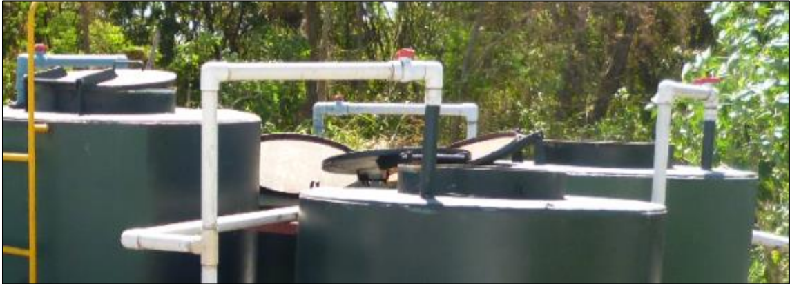
Figura 15. Llenado de tanques de floculación
