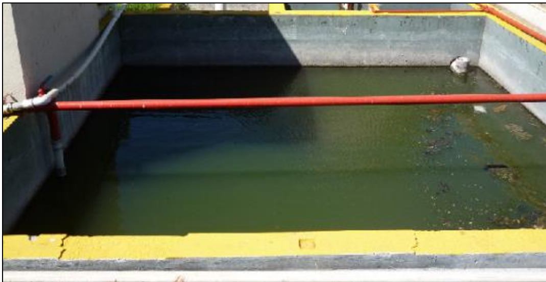
Figura 18. Tanque reactor aeróbico.
