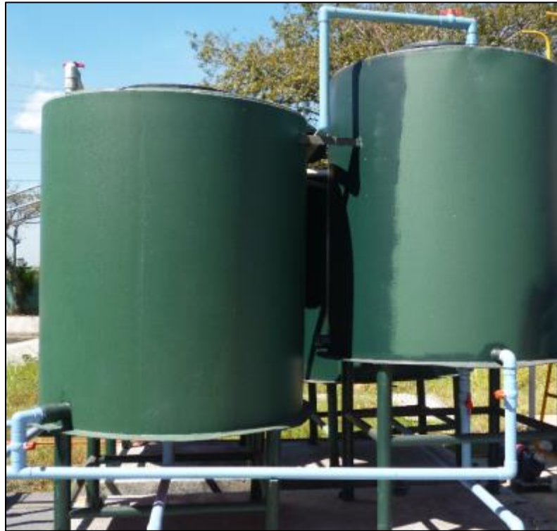
Figura 8. Tanques de floculación.
