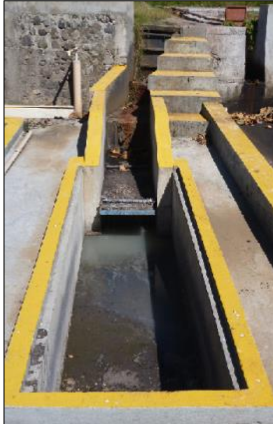
Figura 16. Rejilla y trampa de flotantes
