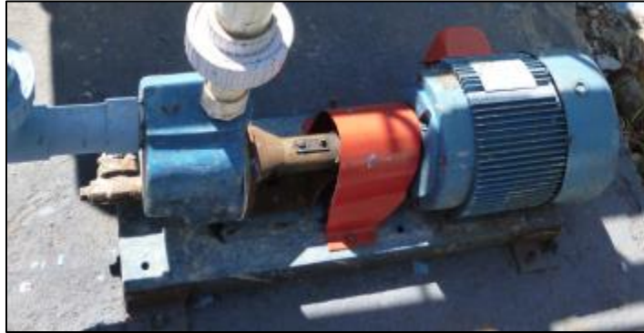
Figura 9. Bomba de 3 Hp.
