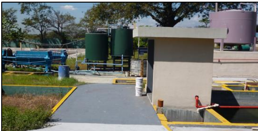
Figura 1. Planta de tratamiento de aguas industriales y residuales.
