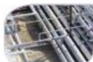
Tratamiento del agua
