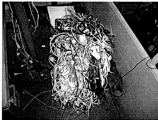
Fotografía 18: Incorrecta identificación de arneses no conformes
