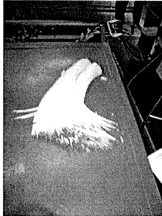
Fotografía 13: Cables cortados sin clasificación
