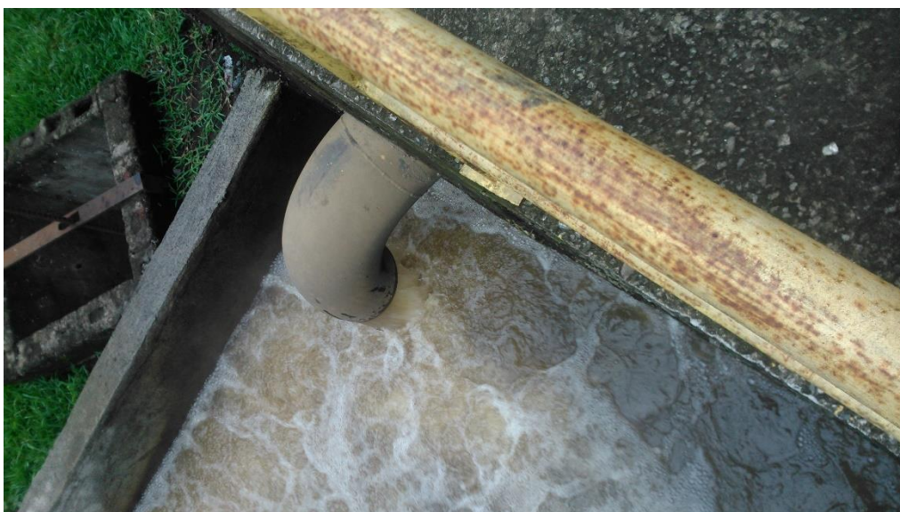
Figura 69. Tubería de alimentación de tanque de mesas de lavado proveniente de condensador barométrico
