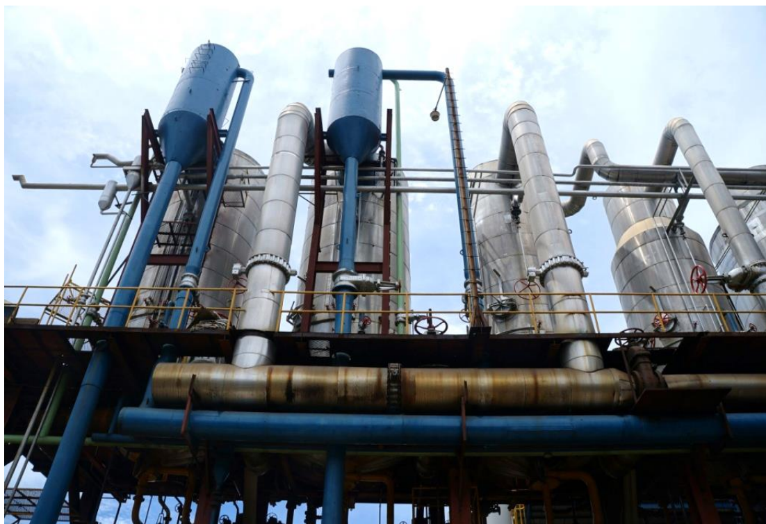
Figura 24. Evaporadores de múltiple efecto.
