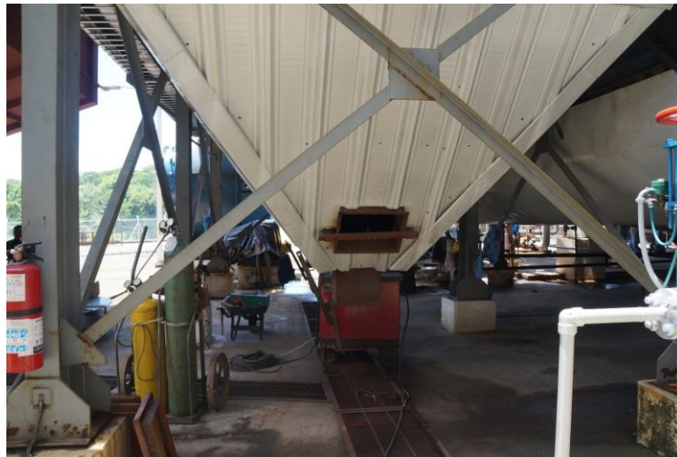
Figura 57. Ceniceros de caldera 6 (ubicados antes del scrubber 6)
