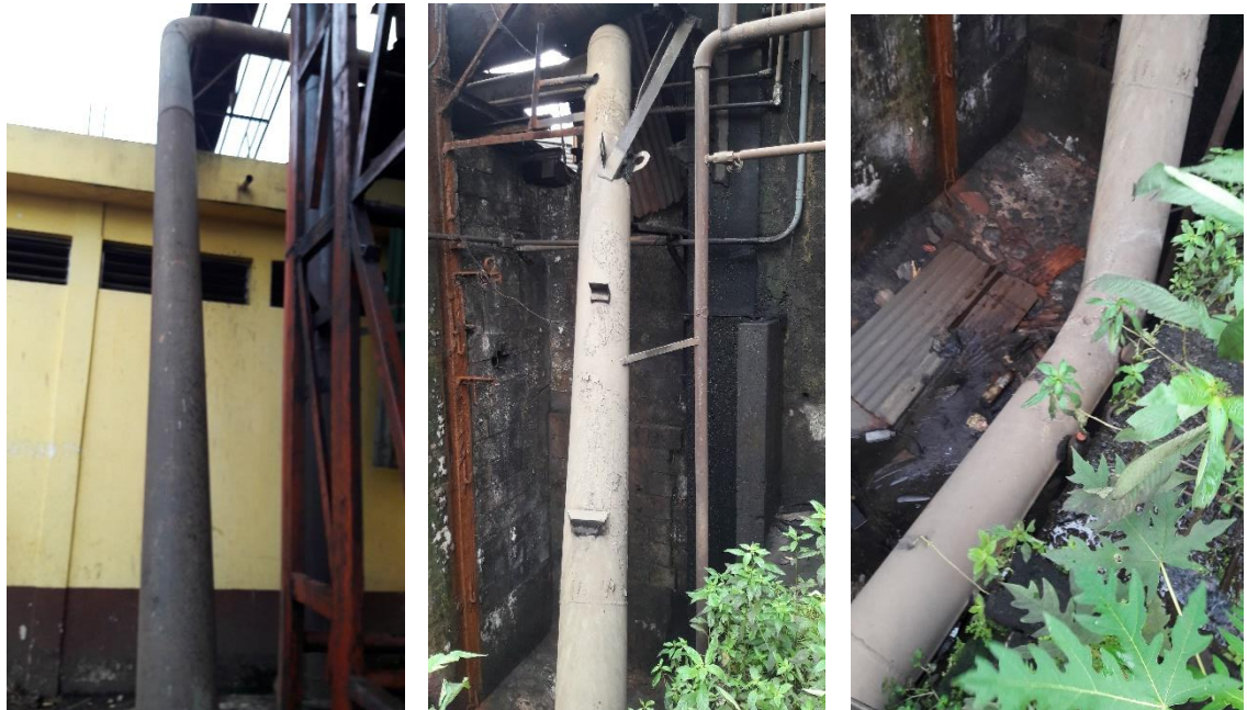
Figura 71. Tubería de agua hacia patio de caña
