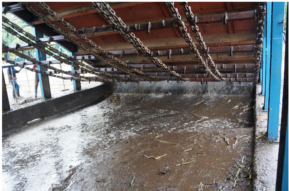
Figura 78. Descarga de agua mesa de lavado de caña 2
