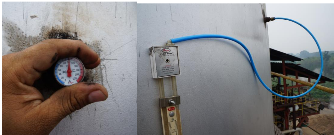
Figura 35. Imagen izquierda, medición de temperatura; imagen derecha, medición de presión; ambos en la salida de los gases residuales del scrubber 5.
