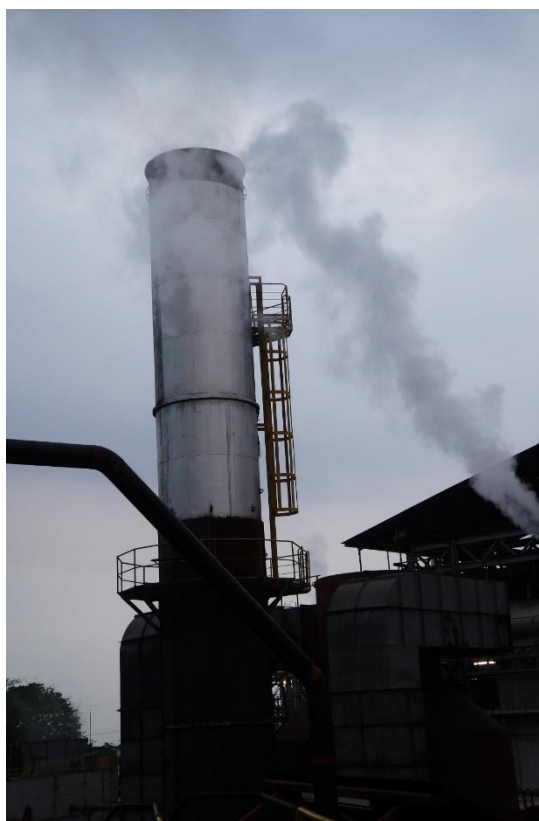
Figura 96. Lavador de gases de combustión de la caldera 6
