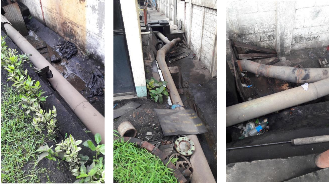
Figura 72. Tubería de agua hacia patio caña
