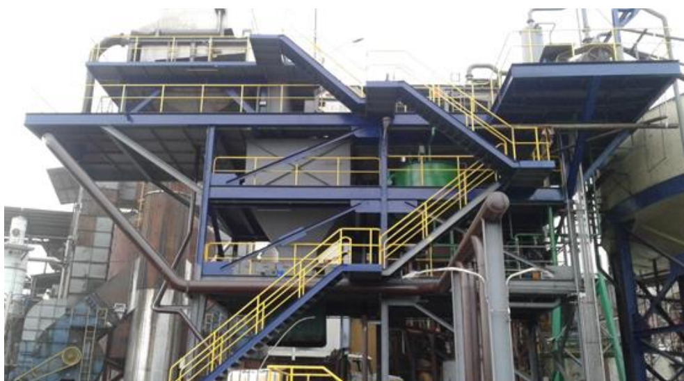
Figura 29. Planta de tratamiento de aguas residuales.
