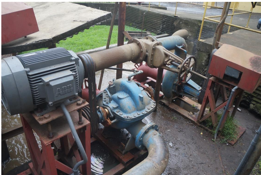
Figura 68. Sistema de bombeo - Mesas de lavado
