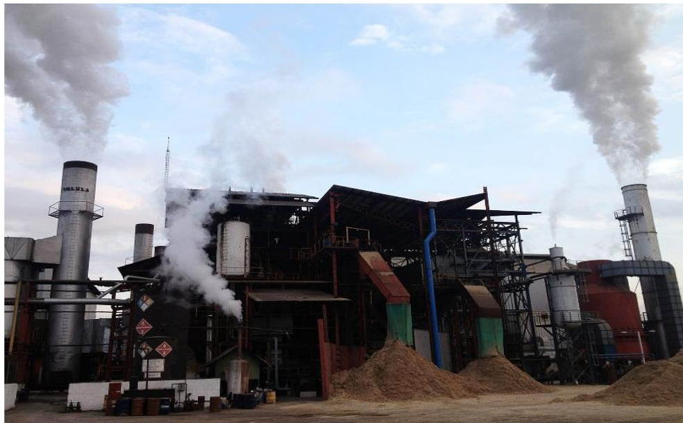
Figura 25. Vista lateral de calderas 5 y 6 (la caldera 5 está ubicada en la parte izquierda de la fotografía y la caldera 6 en la parte derecha)
