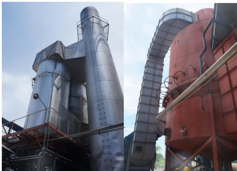
Figura 26. Scrubber de caldera 5 (izquierda) y scrubber de caldera 6 (derecha)
