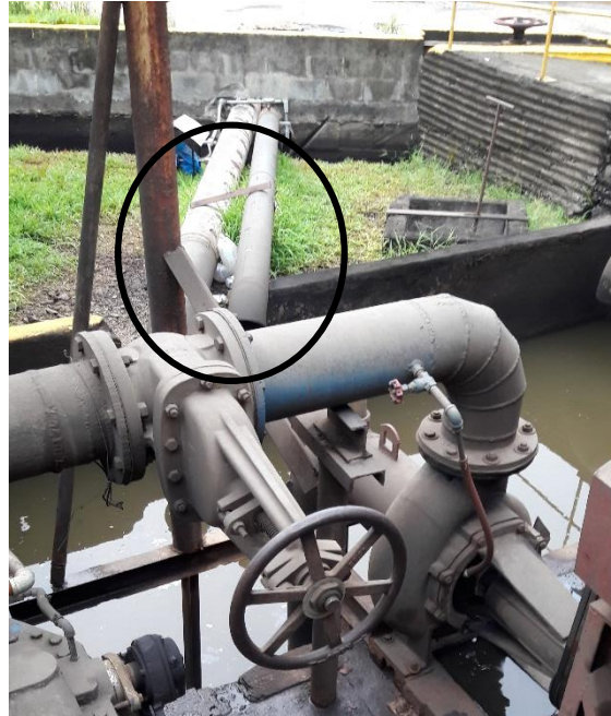
Figura 70. Tuberías de alimentación de tanque de mesas de lavado proveniente de planta de tratamiento de aguas residuales
