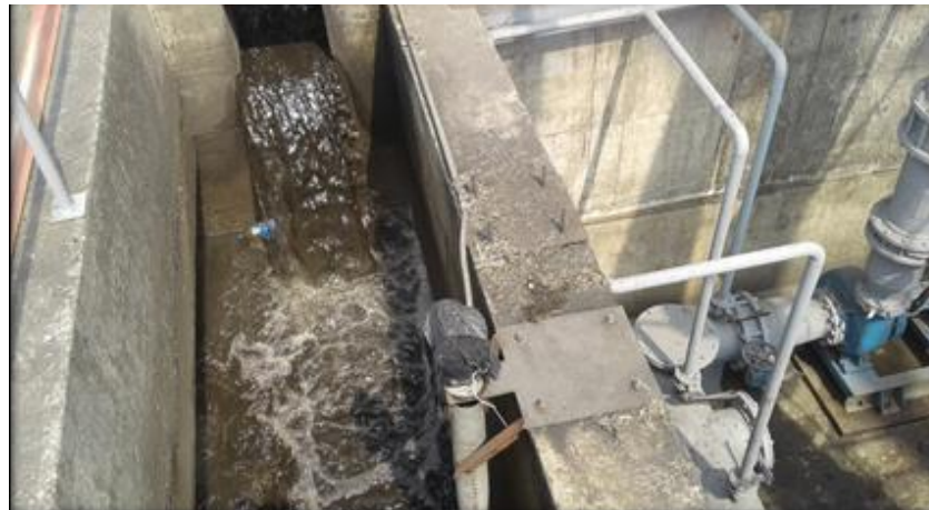
Figura 112. Tanque de alimentación de planta de tratamiento y respectivas bombas para su transporte
