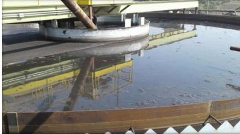
Figura 111. Clarificador de planta de tratamiento en operación
