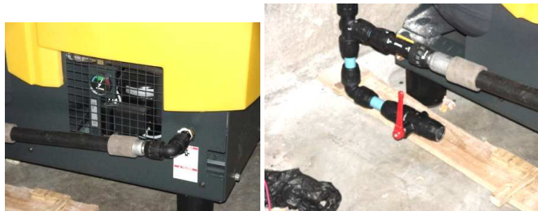
Figura 16: Tubería de salida del compresor, manguera flexible y válvula de alivio
