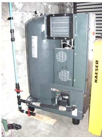
Figura 11: Interior izquierda del compresor
