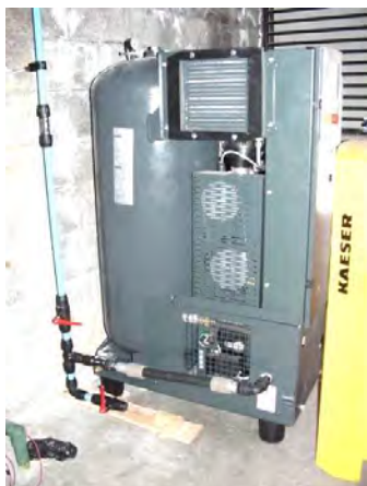
Figura 11: Interior izquierda del compresor
