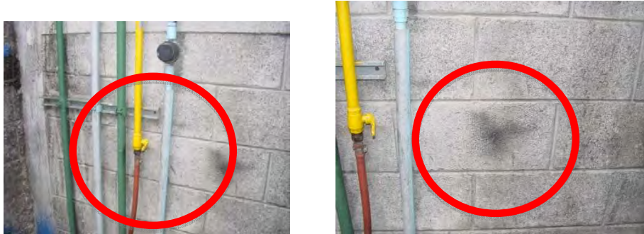
Figura 29: Salida de aire comprimido (tubería amarilla), mancha de aceite del aire generado
