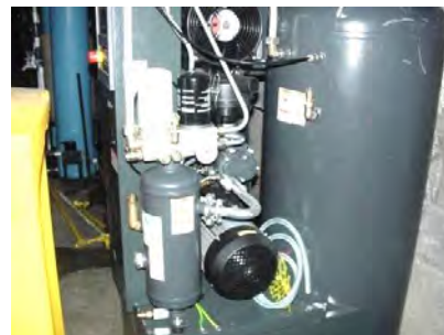
Figura 10: Interior derecha de compresor
